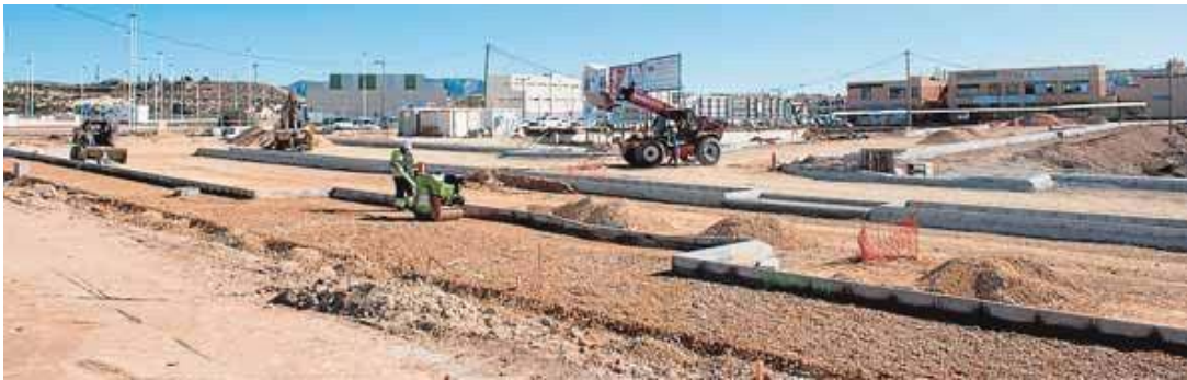
Los operarios trabajan en la construcción del nuevo parque comercial del polígono La Charca :: AYRO
